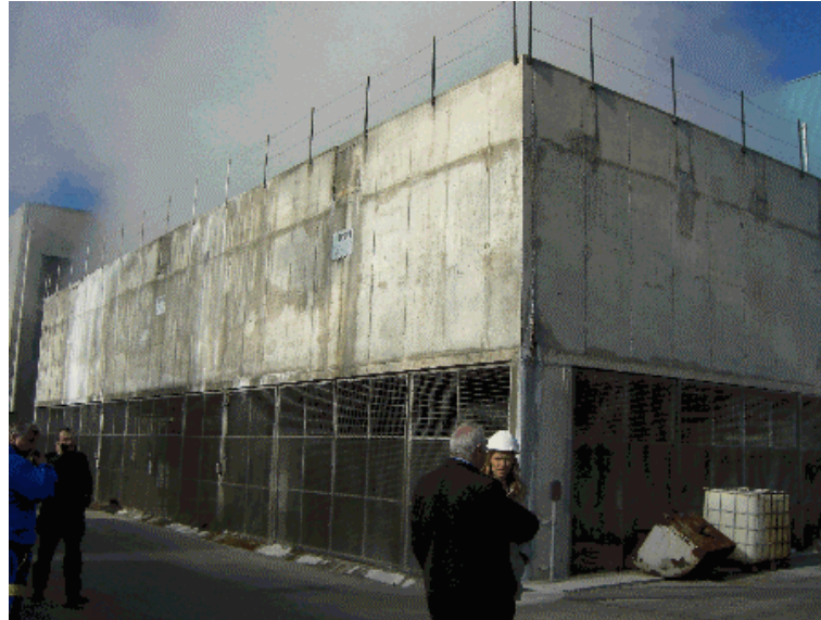
Foto 1 - Torre di Refrigerazione del Termovalorizzatore di AcegasAps
